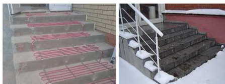
Рисунок 3 – Применение саморегулирующего греющего кабеля в лестничных площадках
