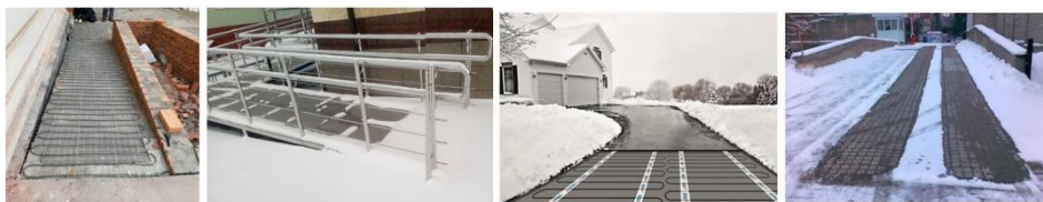
Рисунок 4 – Применение саморегулирующего греющего кабеля в пандусах в пешеходных дорожках и в небольших автомобильных дорогах
